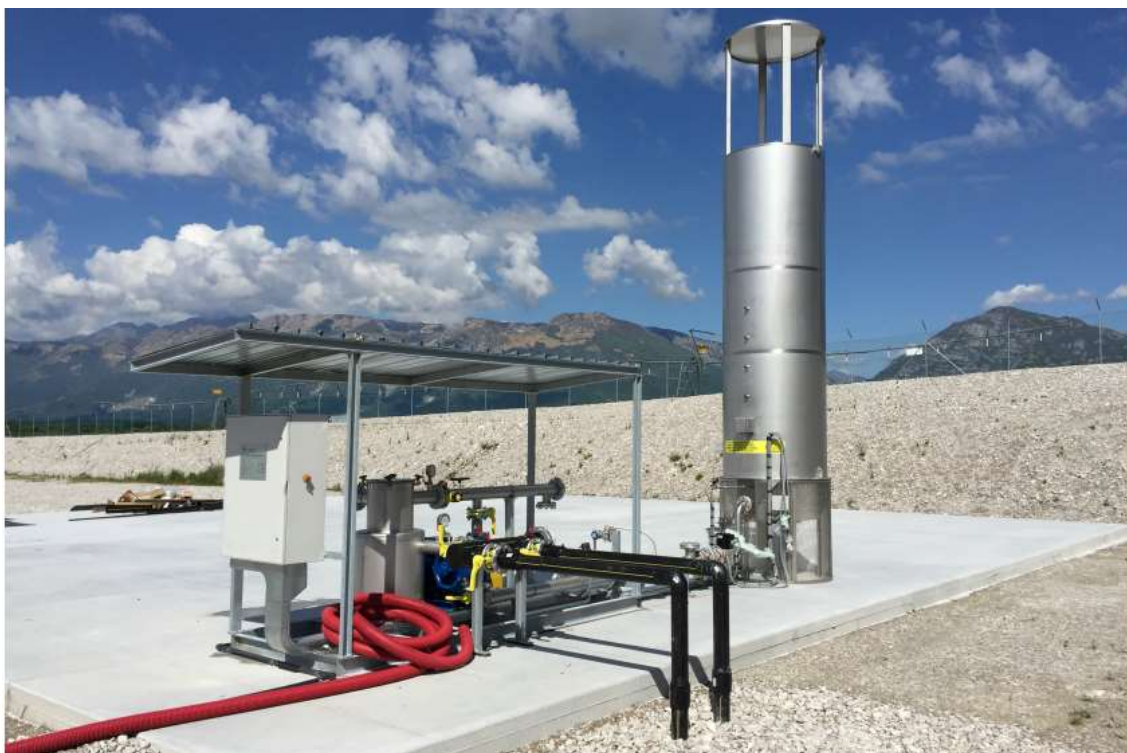
Рис.4. Общия станция для создания разрежения отбора конденсата и свеча для сжигания
