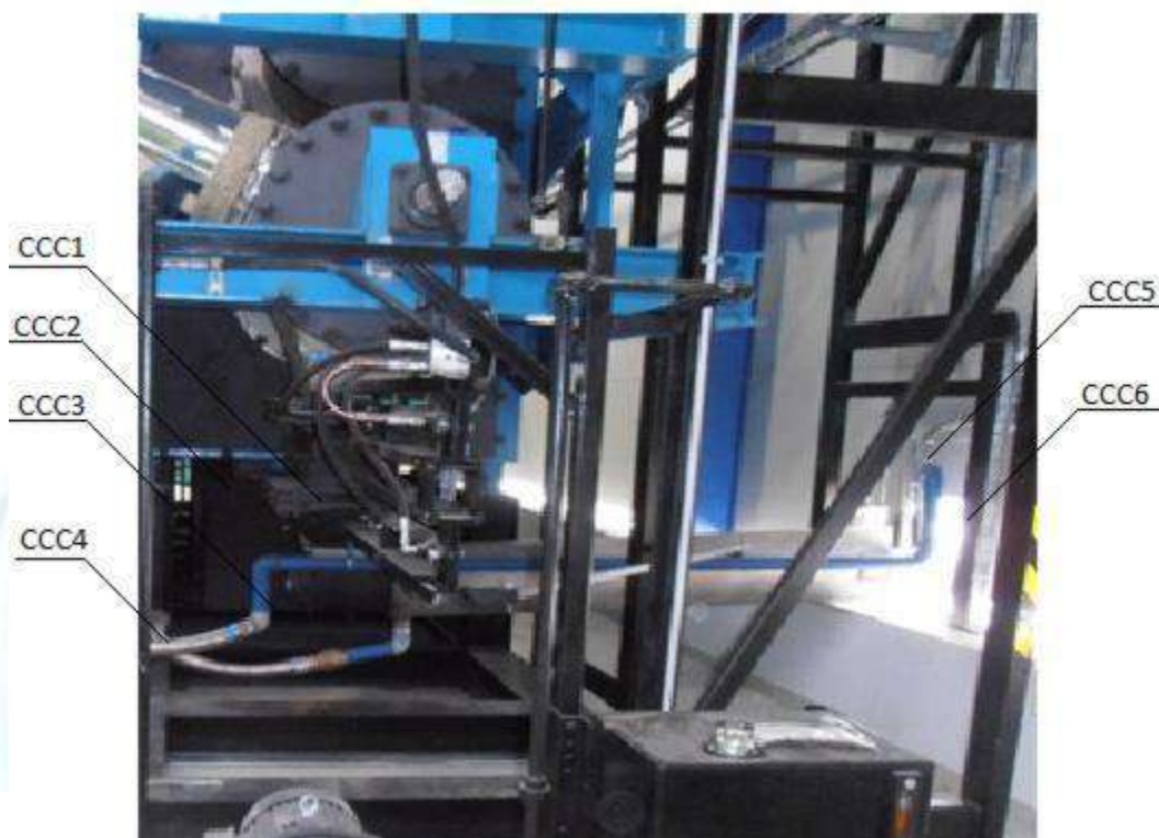
Системы охлаждения углерода и конвейеры
