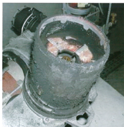
Пример грязной горелки
