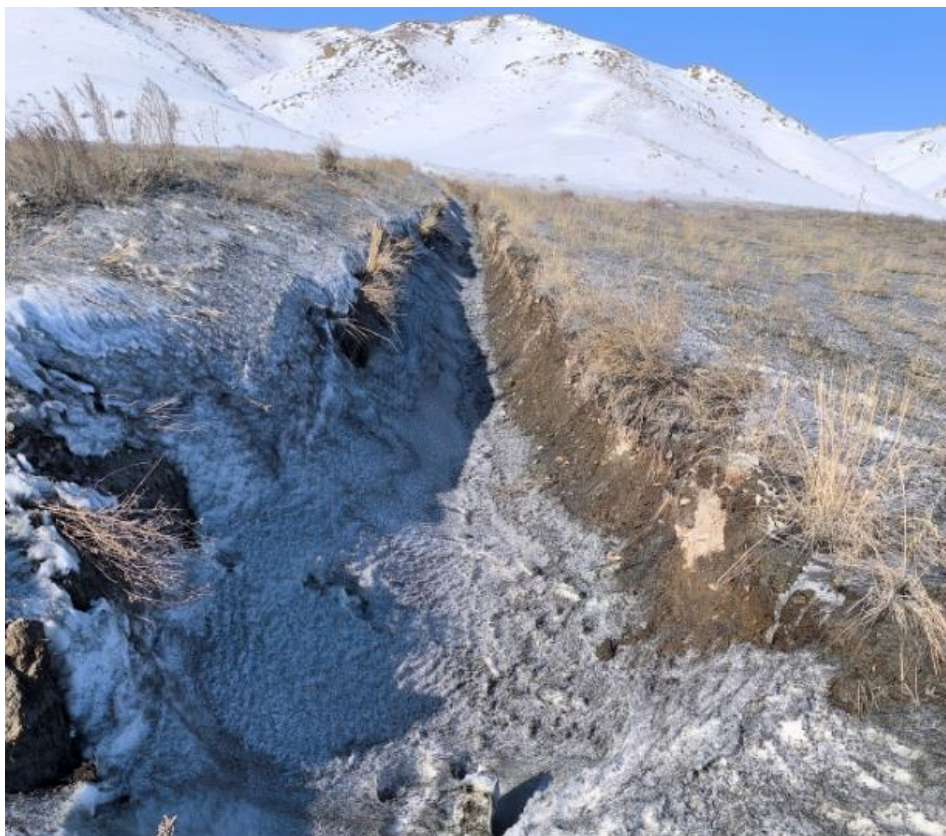
Фото 12. Нагорная канава для отвода талых и дождевых вод
