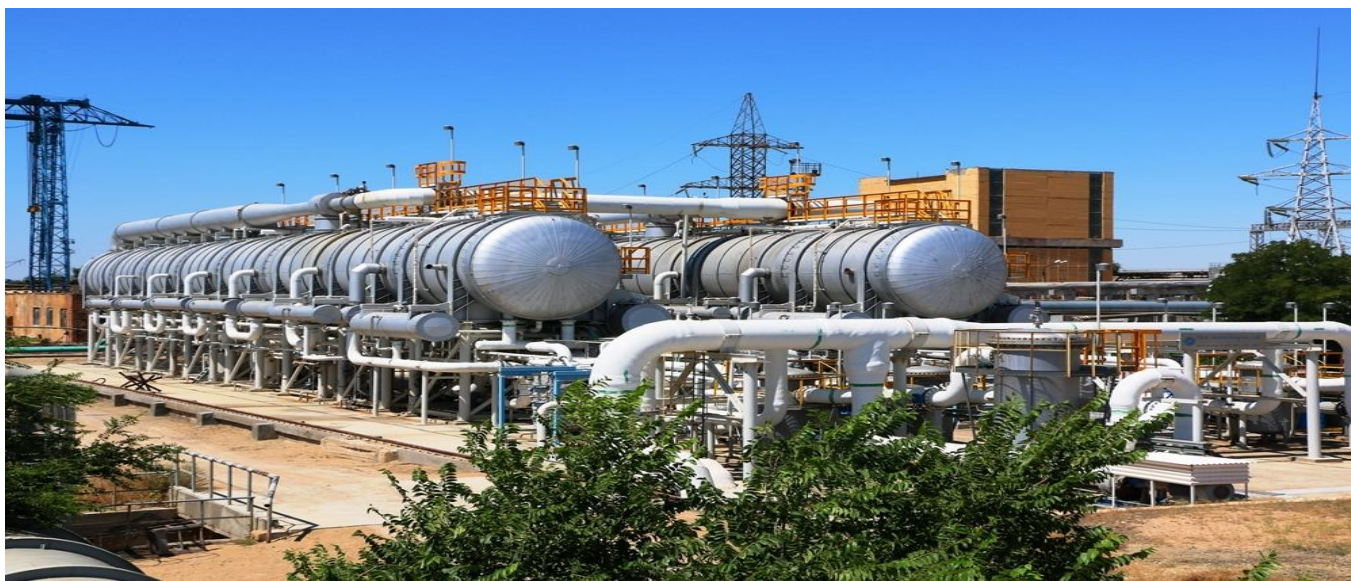
Рис 6.2.2 Новые горизонтальные опреснительные установки израильского производства.
