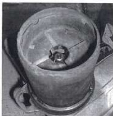
Пример чистой горелки
