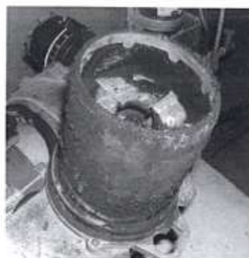
Пример грязной горелки
