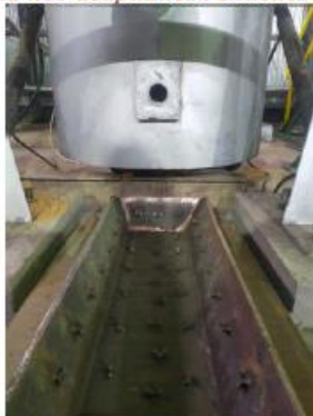
Сливная ванна под аварийным сливным отверстием
