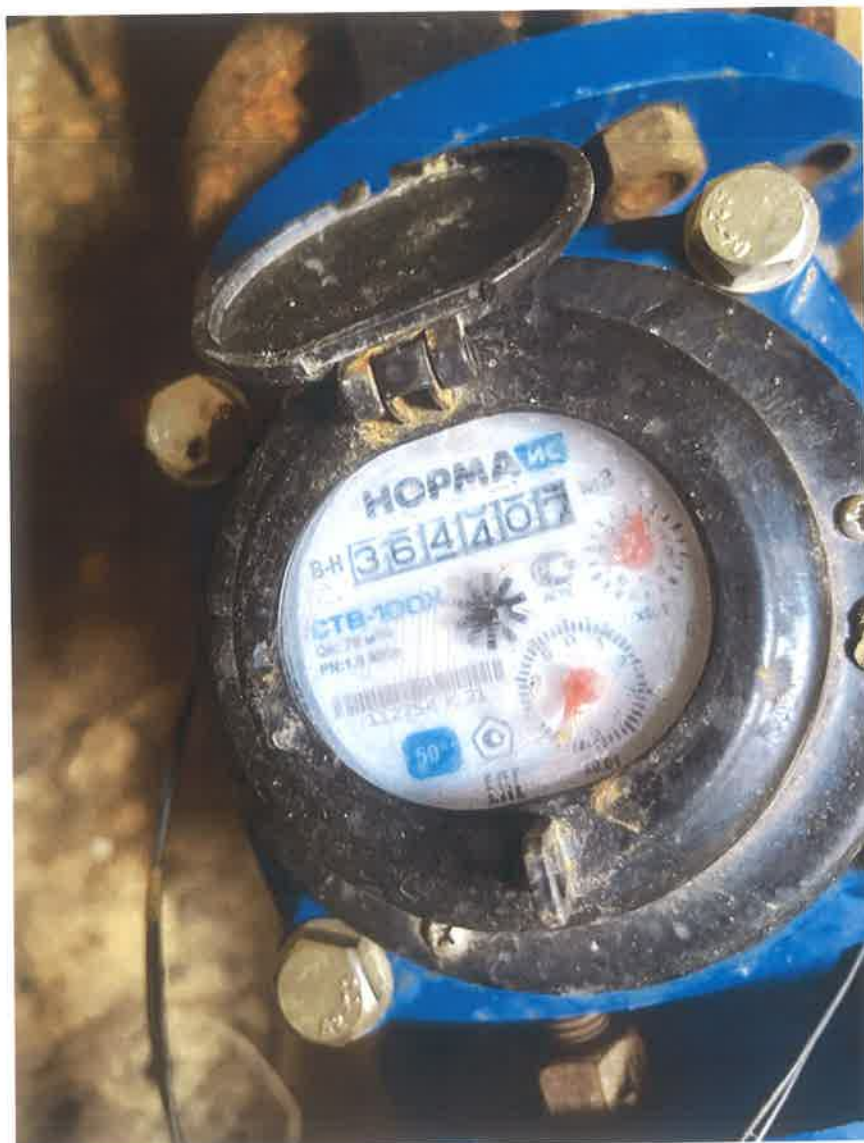
Водомерный счётчик на скважине №70.
