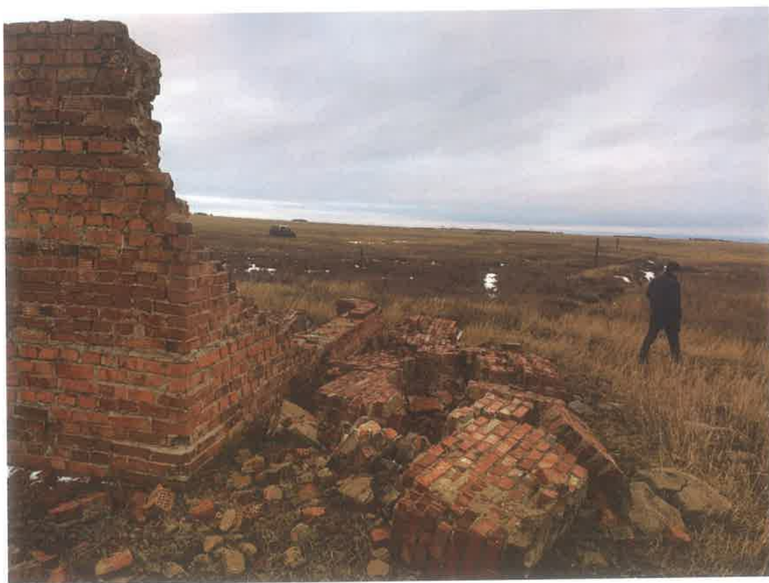
Состояние бывшего павильона на скважине №130
