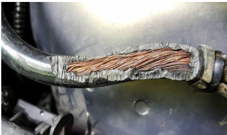
Рисунок 14 – Поврежденный грызунами электрический кабель
