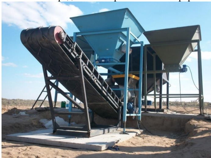
Рис.-2.11.1. Установка переработки бурового шлама -10С.
