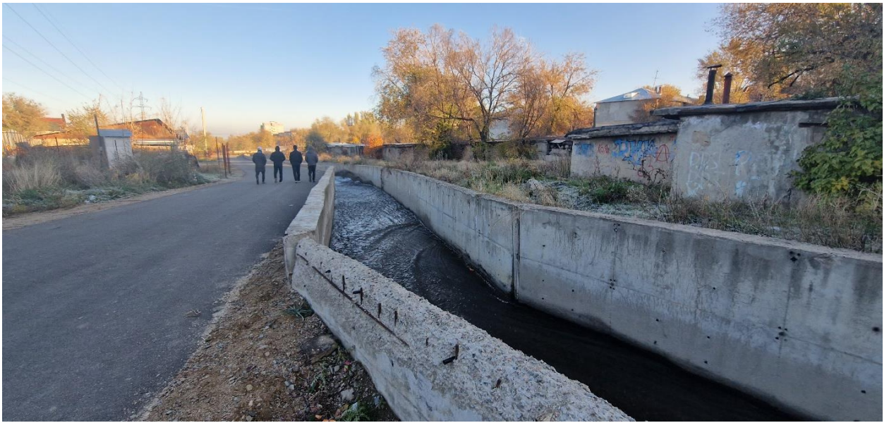
Фото 4. Разрушение верхней части крепления
