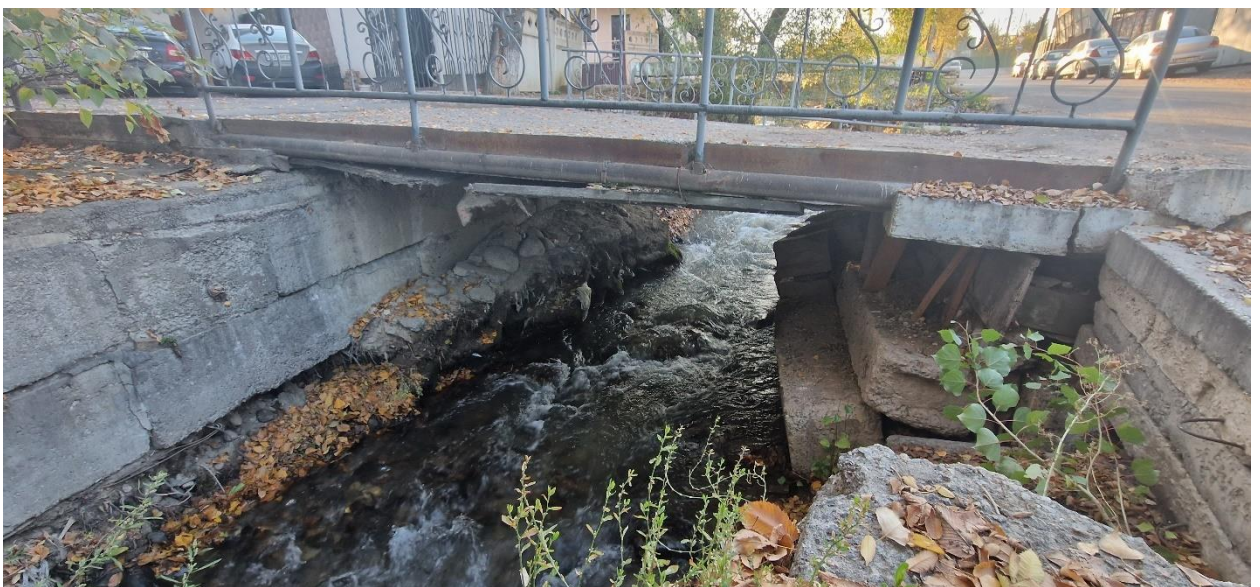
Фото 6. Переезды не отвечают современным техническим требованиям
