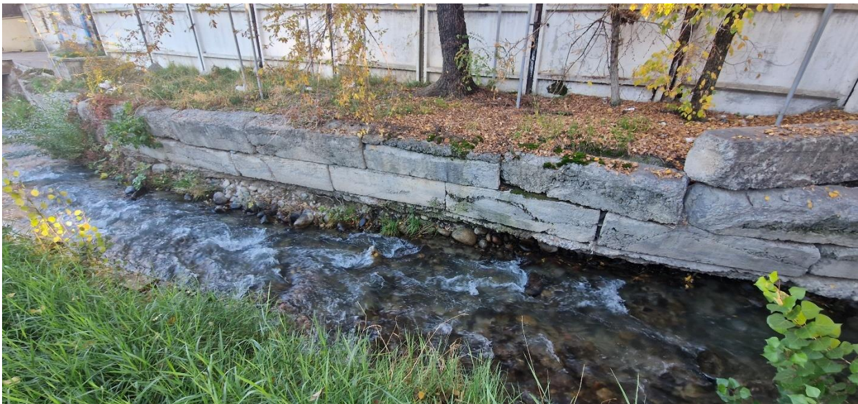
Фото 1. Неудовлетворительное состояние и отсутствие крепления русла
