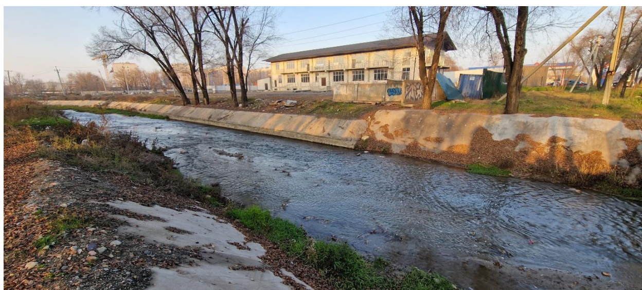
Фото 12. Разрушенная облицовка ниже пр. Райымбека
