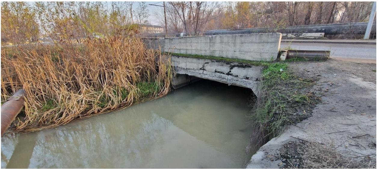
Фото 7. Трубчатые переходы зашлены
