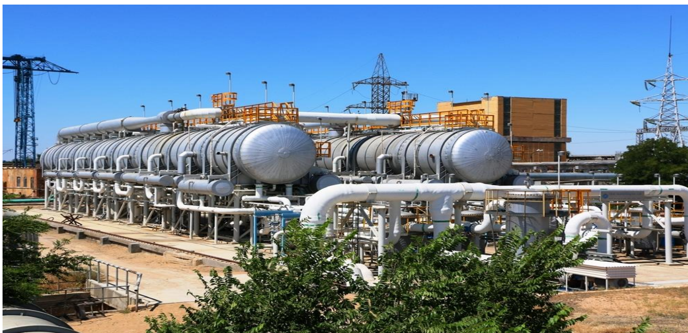
Рис 6.2.2 Новые горизонтальные опреснительные установки израильского производства.
