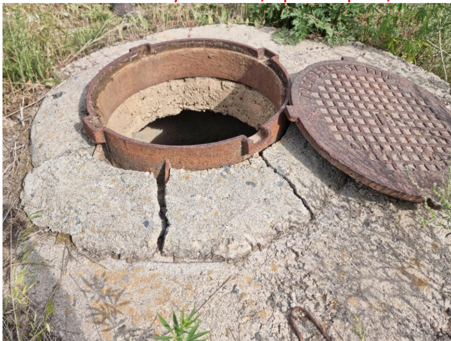
Рисунок 13. Повреждения отмостки колодцев.
