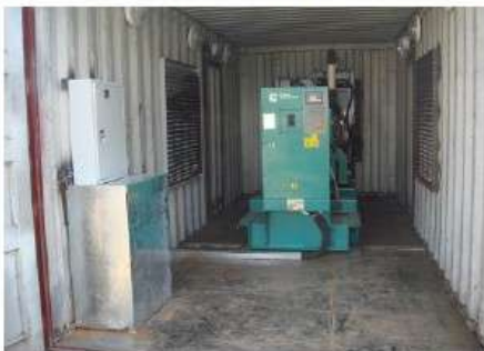
Дизель-генератор в контейнере ↑
