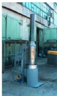
Установка термической утилизации мехпримесей ↑
