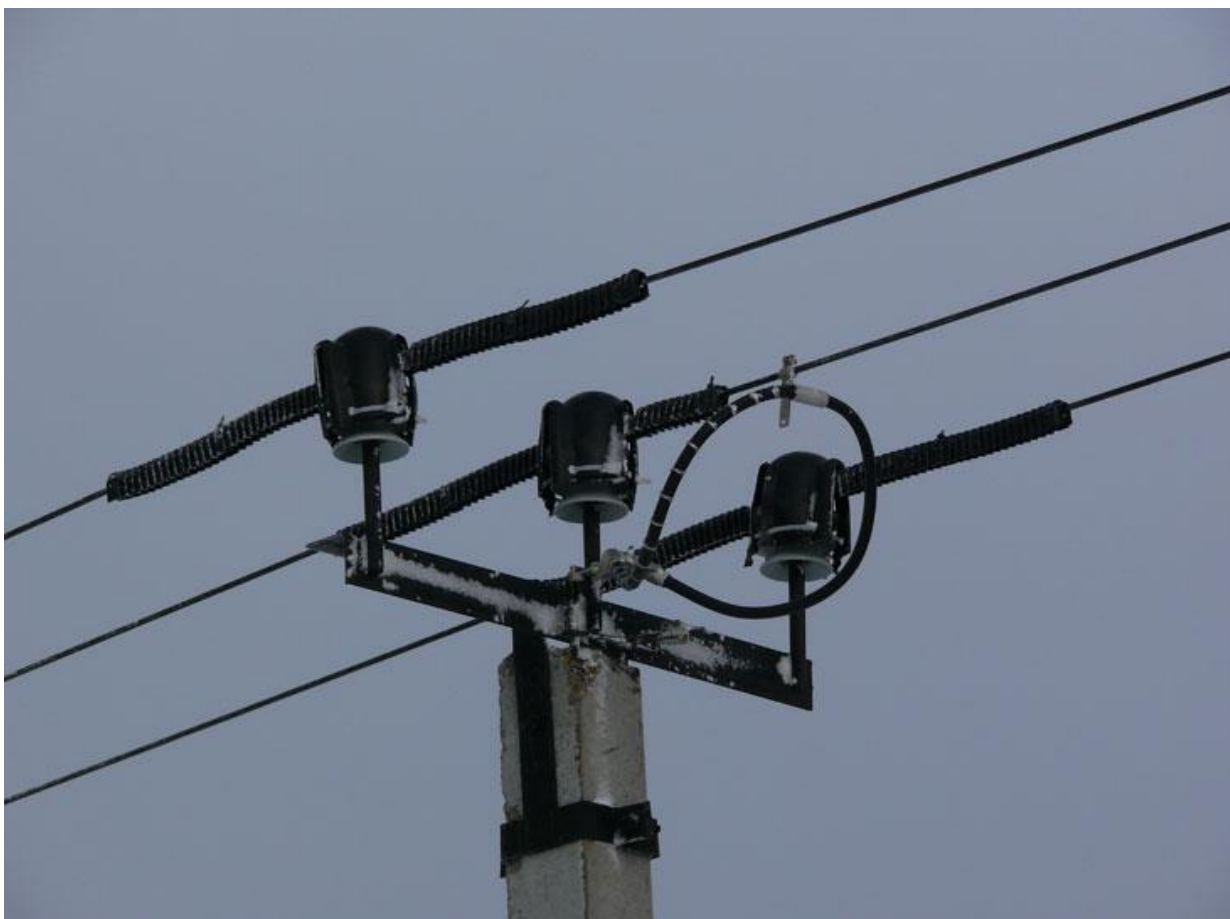
Рис. 15. Пример птицевзащитных устройств на ЛЭП
