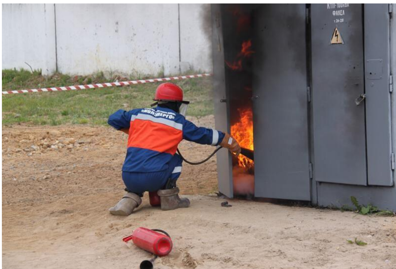
Рис. 6. Пример возникновения пожара в ячейке трансформатора КТП-10 (0,4 кВ) по допуску https://www.complex-safety.com/stati-o-pozharnoj-bezopasnosti/kak-obespechit-pozharnuyu-bezopasnost-v-elektrostanovkakh/
