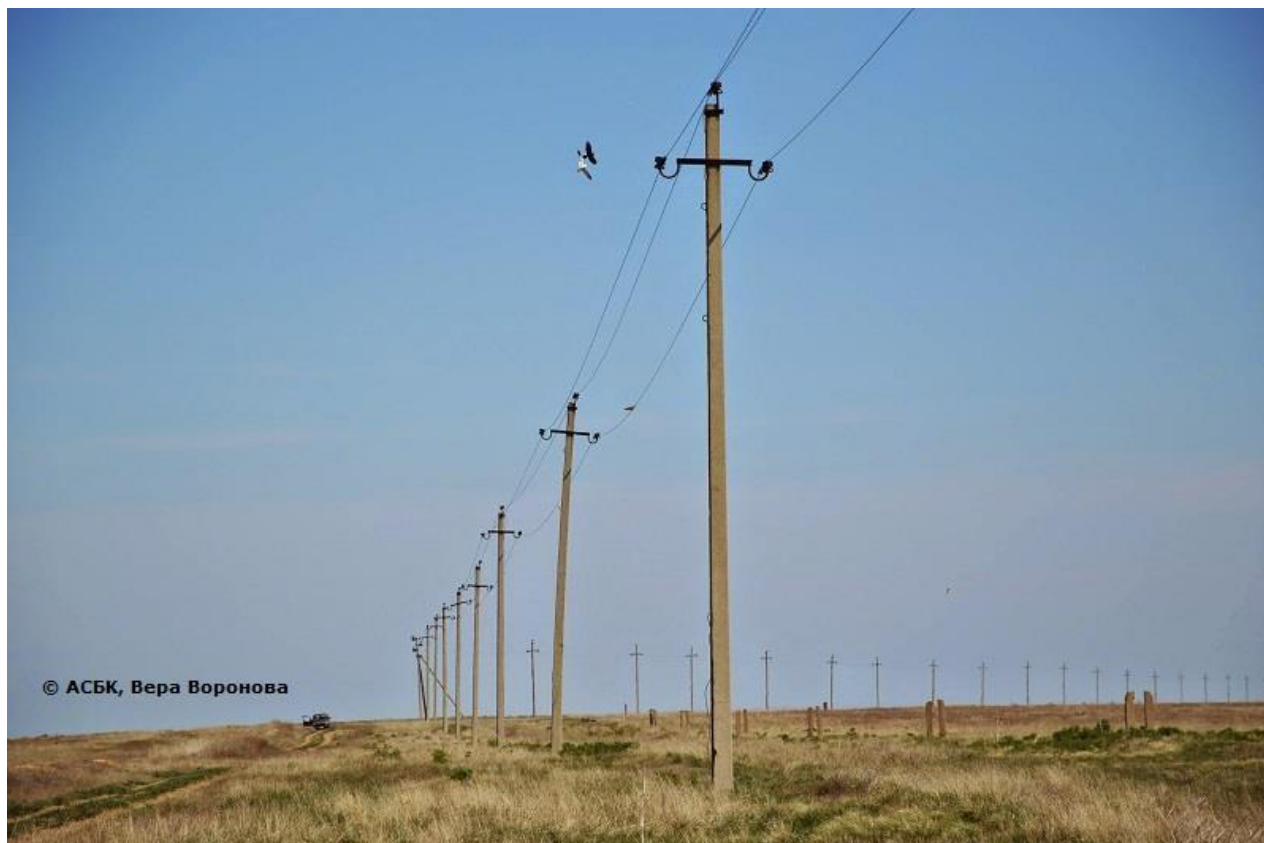
Рис. 13. Опасные для птиц конструкции ЛЭП ( https://www.acbk.kz/article/default/view?id=359 )
