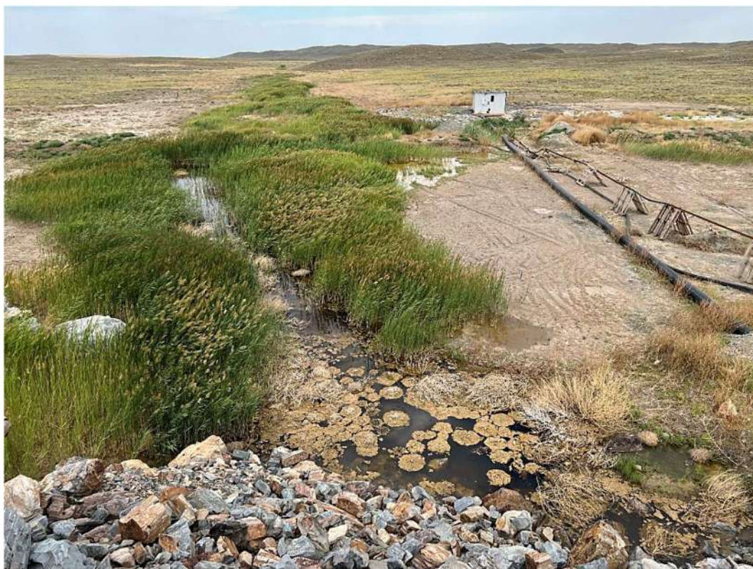
Рисунок 6.1 – Водопроявление у основания северо-западной дамбы третьей карты хвостохранилища
