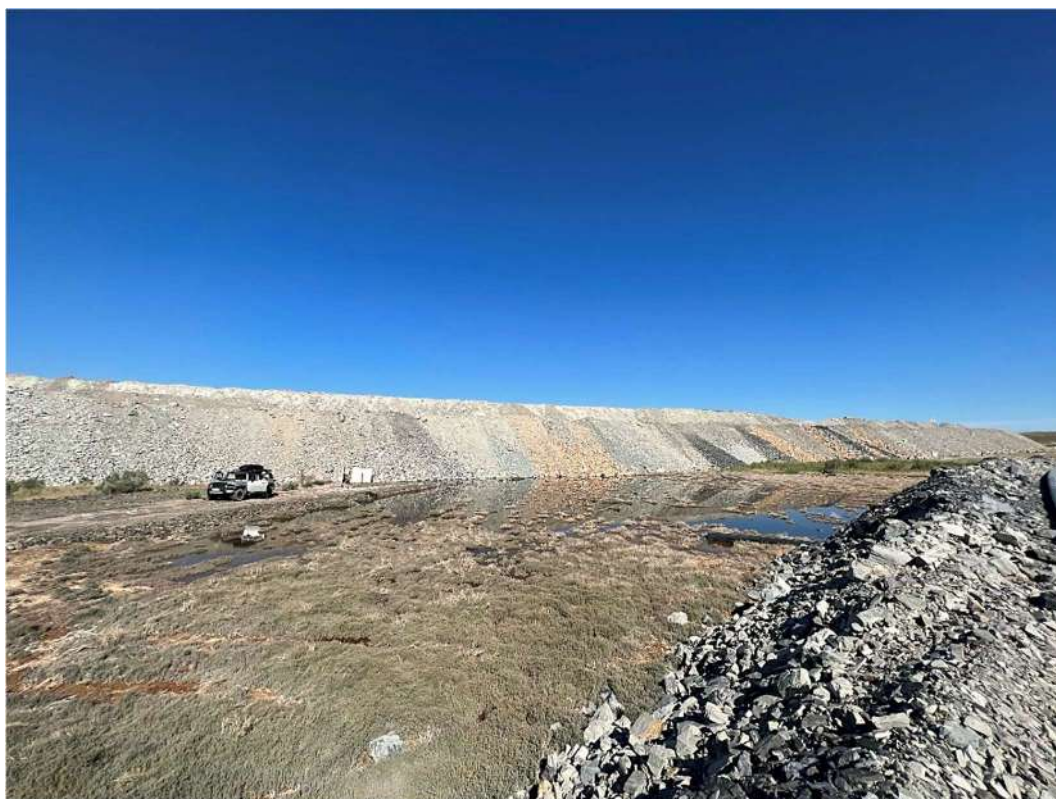
Рисунок 6.2 – Водопроявление у основания северной дамбы второй карты хвостохранилища
