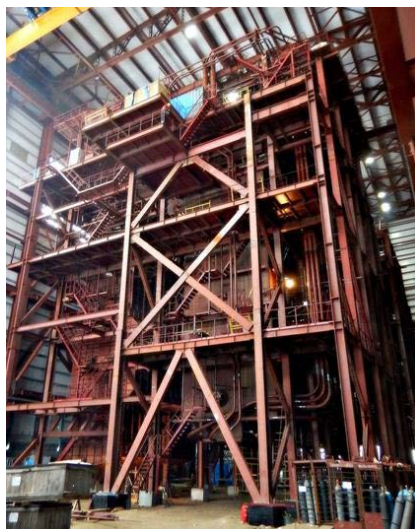
Рисунок 2.1. Существующий котлоагрегат БКЗ-160-100ГМ ст. №7 ТЭЦ-1
