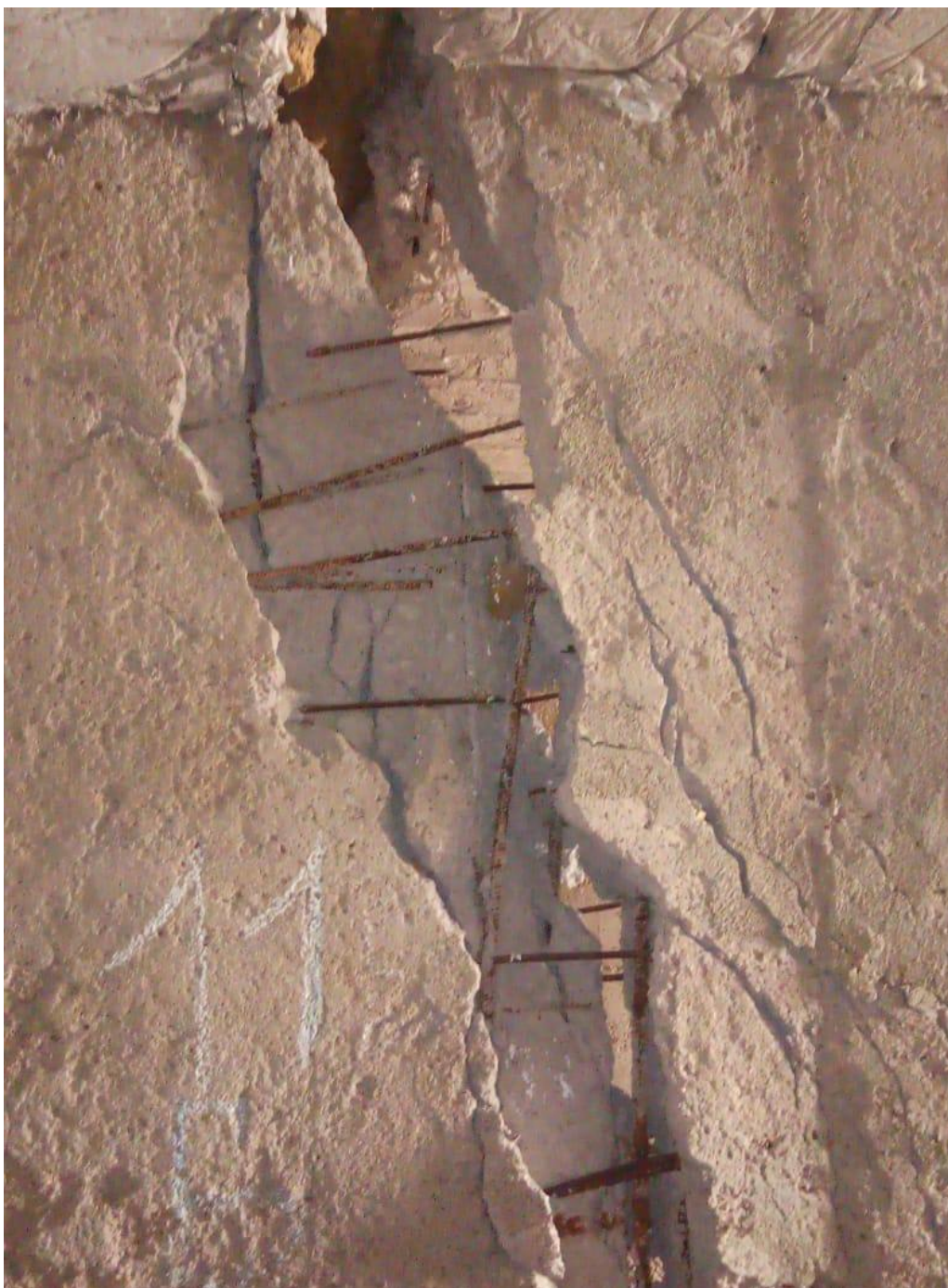
Рис. 10 – Разлом в стене с разрывом арматуры
