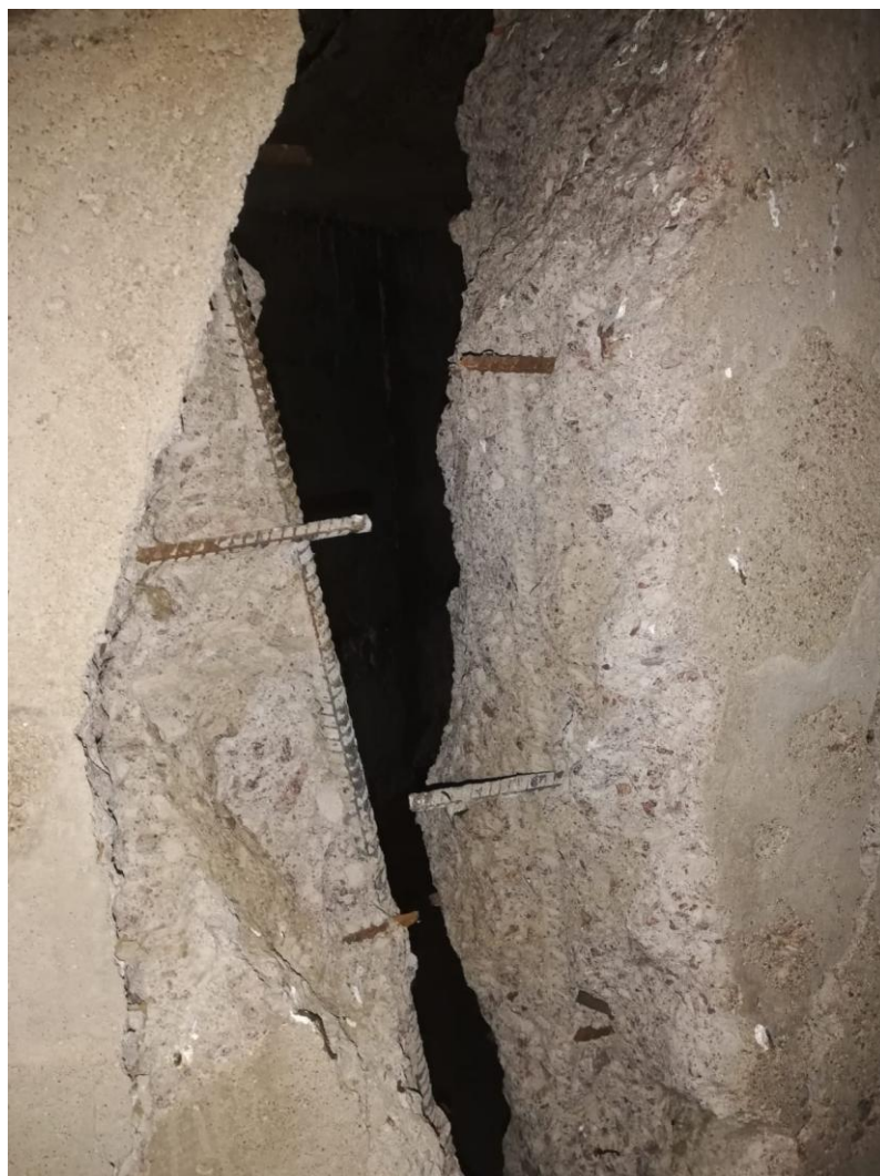
Рис. 8 – Разлом в стене с разрывом арматуры
