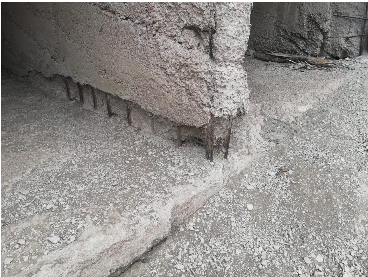
Рис. 21 – Разрушение бетона в основании стены галереи
