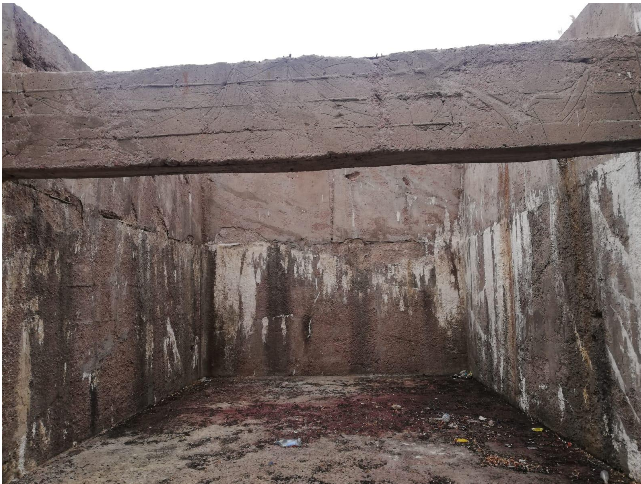
Рис. 13 – Выщелачивание защитного слоя бетона сооружения
