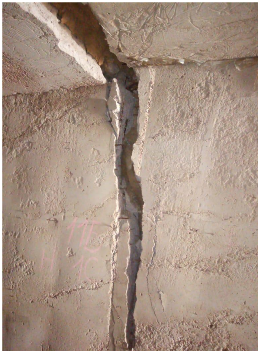
Рис. 9 – Разлом в стене с разрывом арматуры
