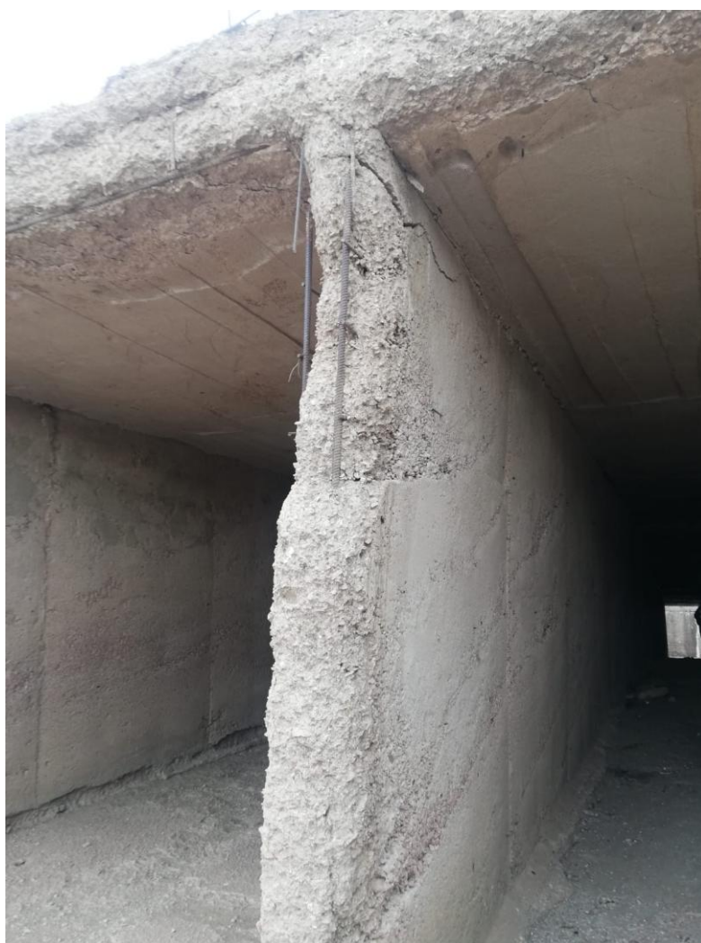
Рис. 6 – Разрушение бетона стены с оголением арматуры
