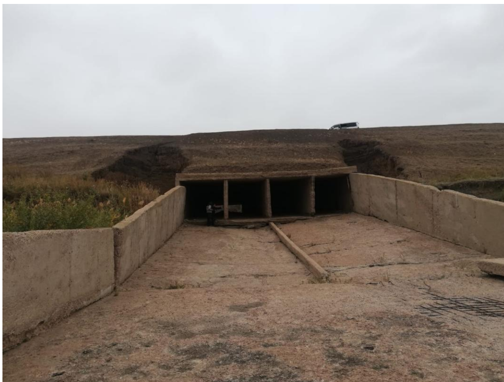
Рис. 5 – Нижний бьеф. деформации основания разрушение защитного слоя бетона днища
