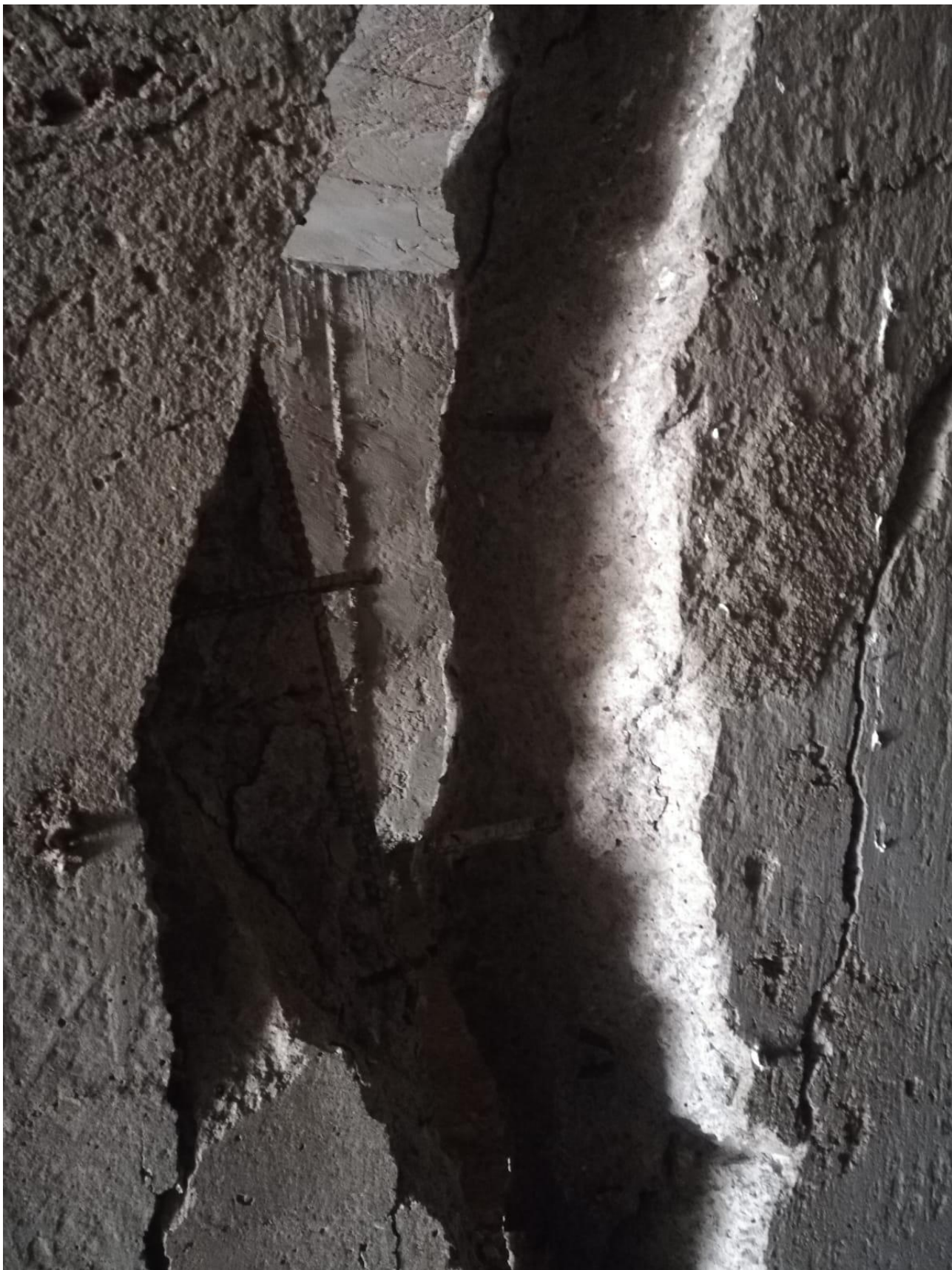
Рис. 12 – Разлом в стене с разрывом арматуры
