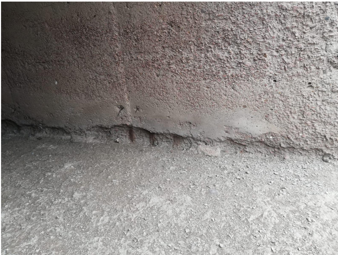
Рис. 18 – Разрушение бетона в основании стены
