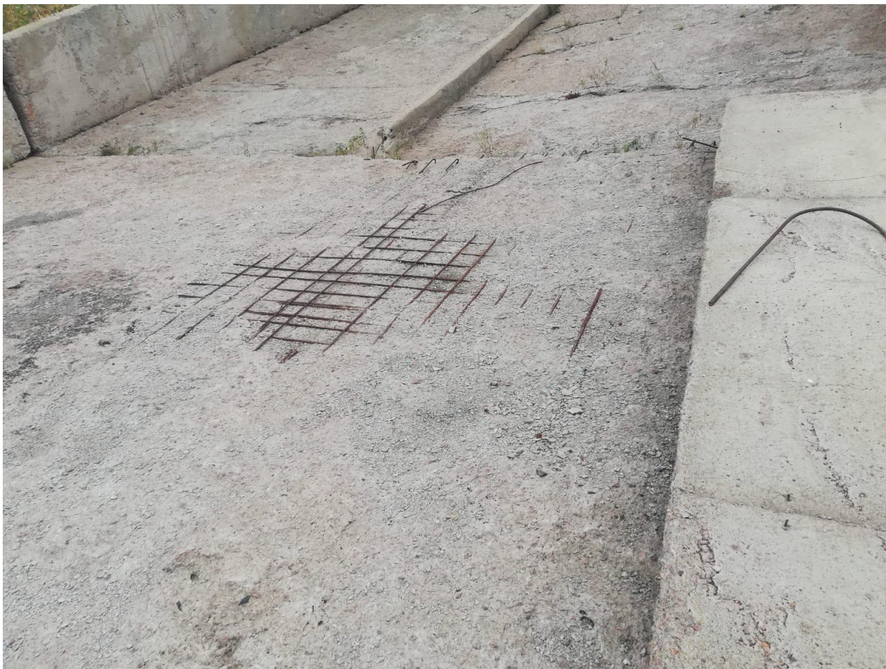
Рис. 11 – Разрушение защитного слоя бетона днища
