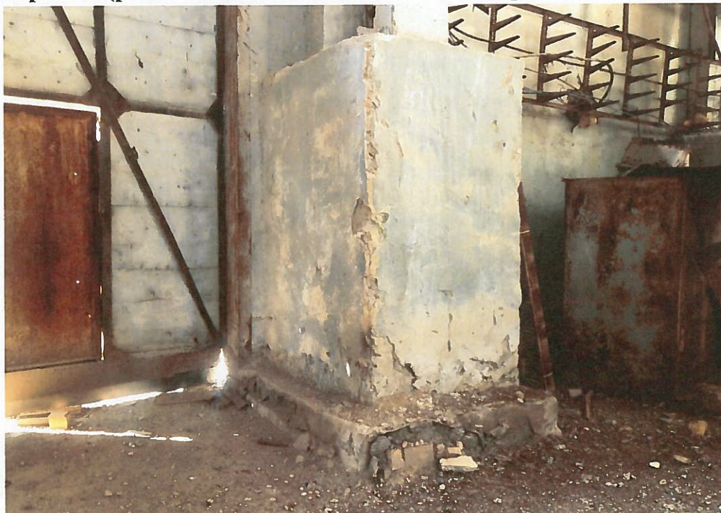
Фото. 5.4.1 А/6-18, Е/6-18 разрушение защитного слоя бетона.
