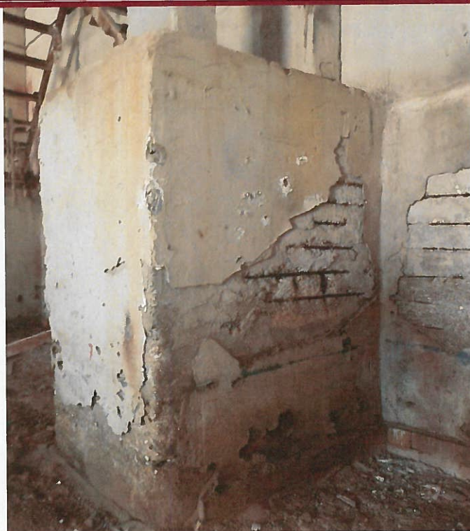
Фото. 5.4.2 А/6-18, Е/6-18 разрушение защитного слоя бетона, оголение арматуры. Коррозия арматуры 0,2-0,4мм.
