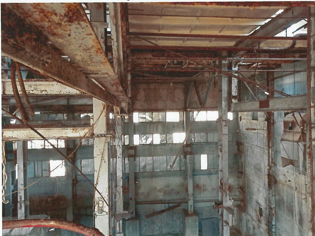
Фото.5.6.1 Коррозия м/к ферм и связей.
