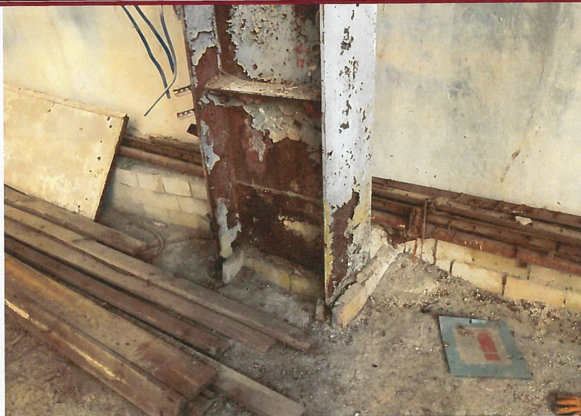
Фото. 5.4.3 В осях А-Е/10, В-Г/6-10, 12, Б/11 разрушение защитного лакокрасочного слоя, пластинчатая коррозия у основания колонны.
