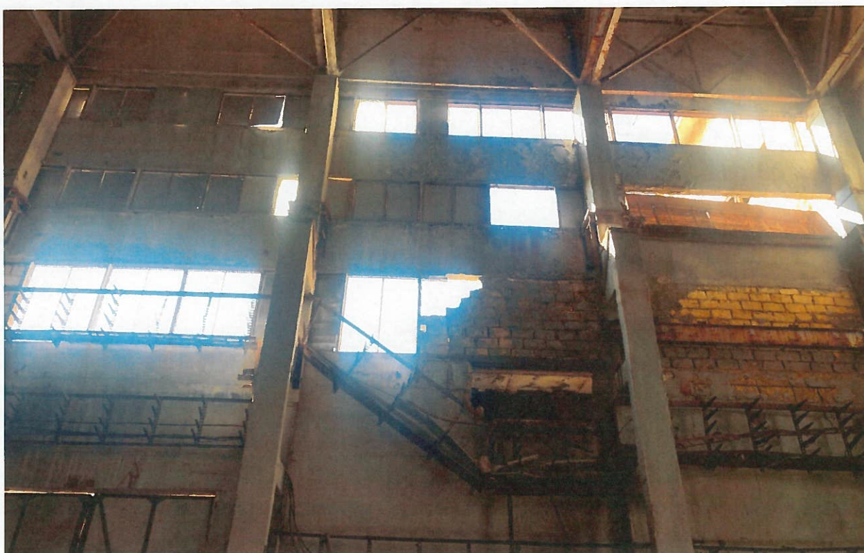
Фото. 5.5.2. Выпадение отдельных камней каменной кладки стенового ограждения в осях А/7-8
