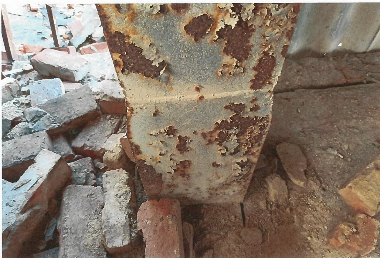
Фото. 5.4.4 В осях В-Г/6-11 Разрушение защитного лакокрасочного покрытия. Язвенная коррозия м/к колонн на глубину до 0,8мм. выше отм. +14,800м.
