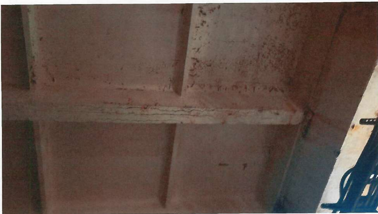
Фото.5.6.2 В осях Б-В/3-4 – трещины в продольных ребрах плит покрытия шириной раскрытия до 6мм, с коррозией арматурного каркаса до 20% от сечения;
