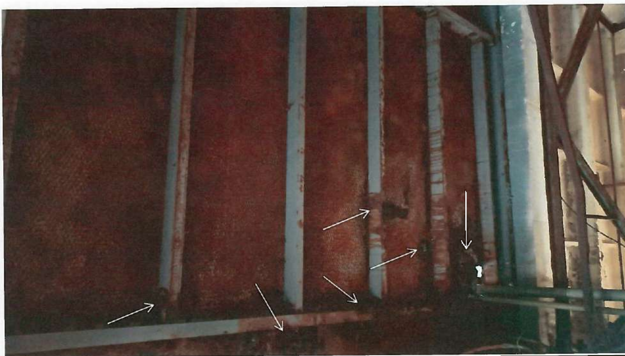
Фото.5.6.4 В осях Б-В/3-4 - разрушение защитного лакокрасочного слоя, сквозная коррозия м/к каркаса и настила перекрытия (до 100% от первоначального сечения).
