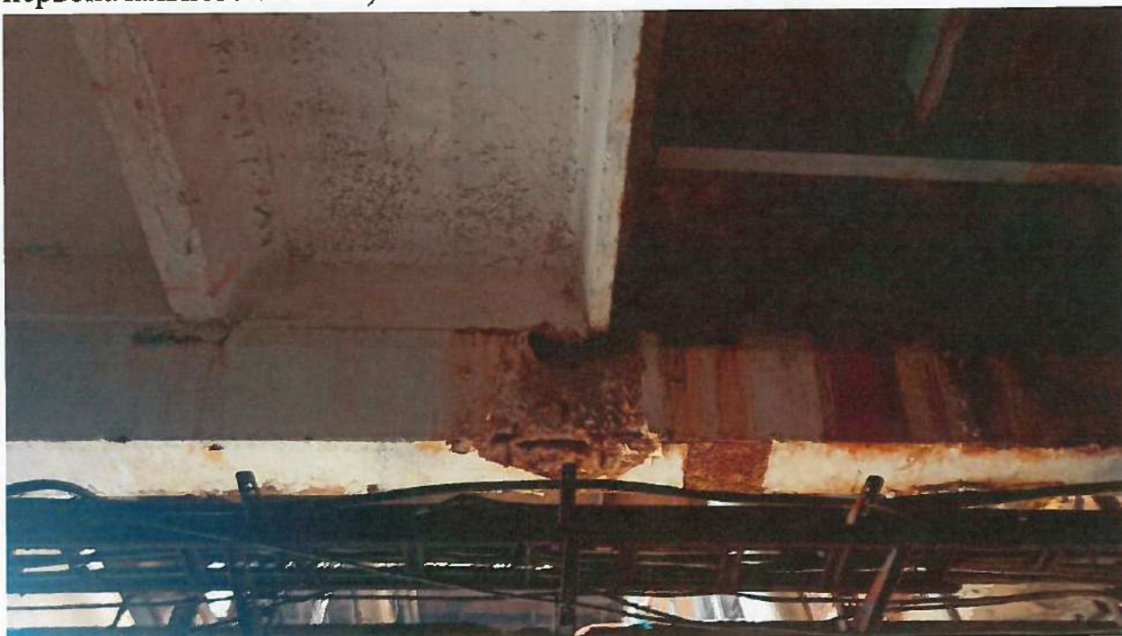
Фото.5.6.5 Балка перекрытия в осях Б-В/4 – разрушение защитного слоя бетона на глубину до 80мм, с оголением и сквозной коррозией боковой нижней и верхней арматуры.
