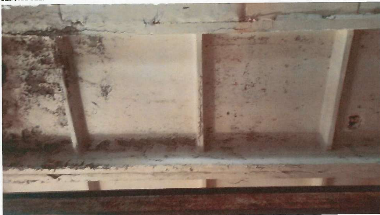
Фото.5.6.1 В осях В-Г/3-4 трещины в продольных и поперечных ребрах плит перекрытия с оголением и коррозией арматурного каркаса. Следы протечек кислоты.
