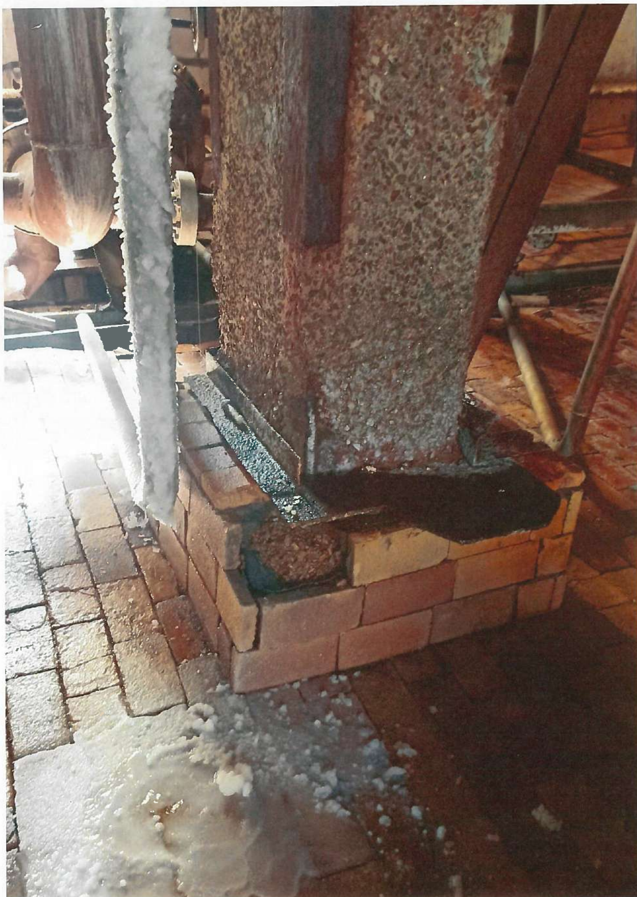
Фото. 5.4.1 В/4 разрушение защитного слоя бетона, оголение и коррозия арматурного каркаса. Коррозия арматурного каркаса 2-4мм
