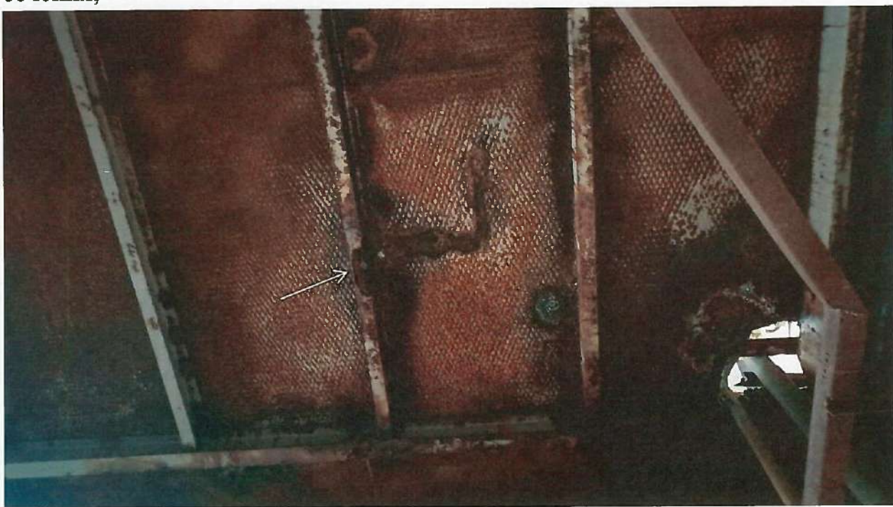
Фото.5.6.3 В осях Б-В/3-4 - разрушение защитного лакокрасочного слоя, сквозная коррозия м/к каркаса и настила перекрытия (до 100% от первоначального сечения).
