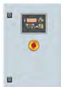
Внешний шкаф автоматического ввода резерва КОНТРОЛЛЕР CC2
