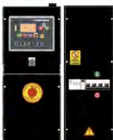
Панель управления ДГУ КОНТРОЛЛЕР AS5
