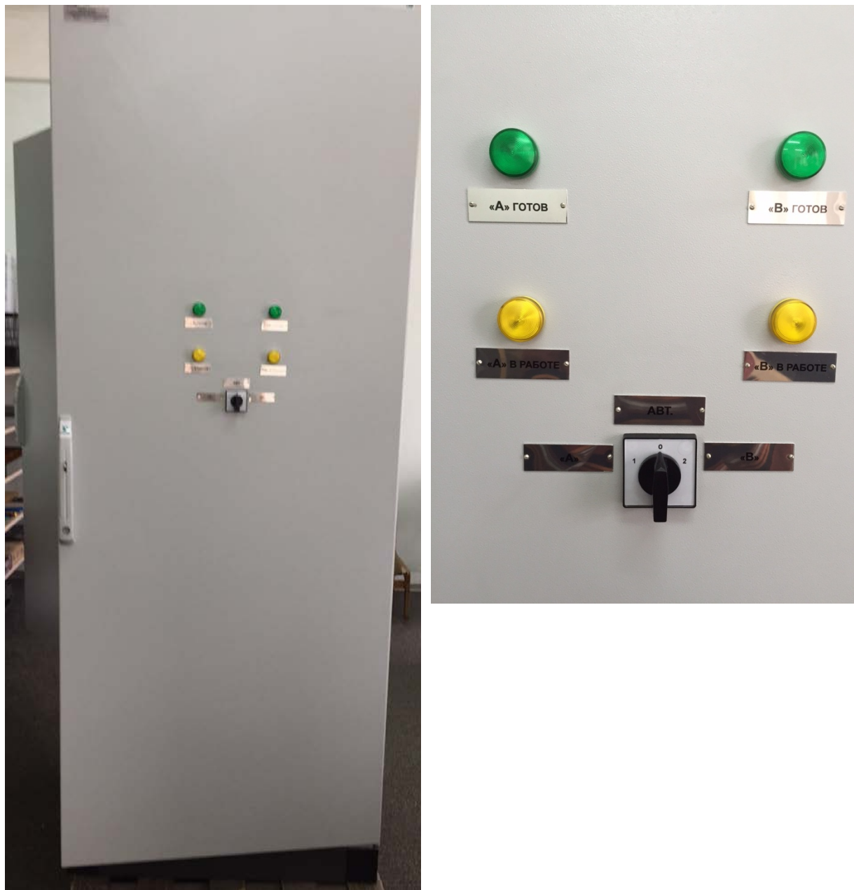
Рисунок 21. Вид спереди шкафа контроллеров.
