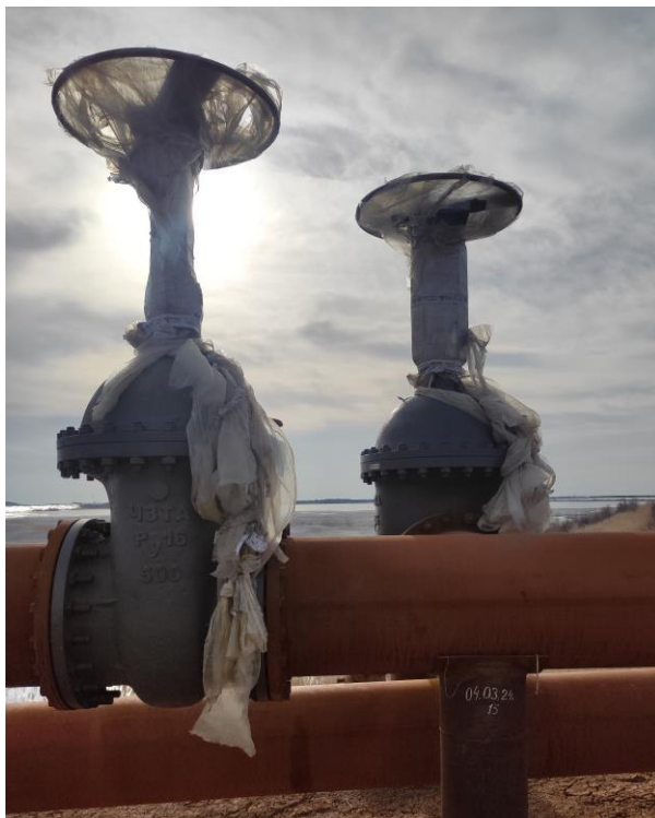
Фото 1 Задвижки на секций №1
