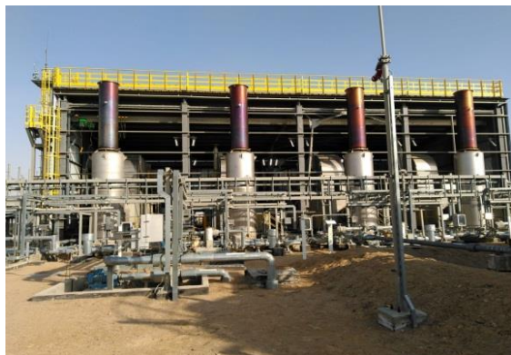
Газ турбиналы электр станциялары
