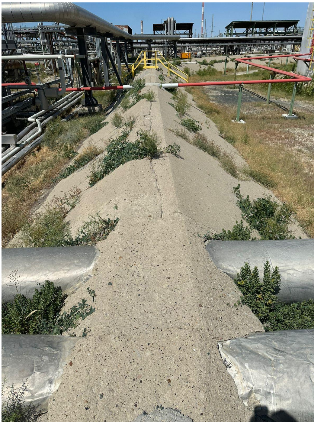
Рис 1.3.5. Бетонное обвалование вокруг резервуаров Т1-Т8
