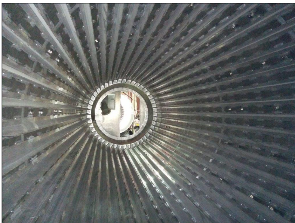
Фото 3 Состояние нового барабана грануляции
