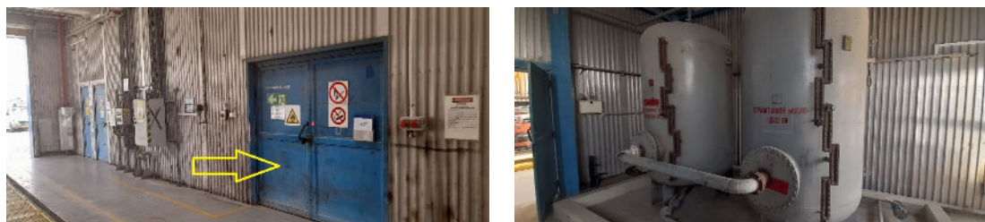
Фото 15 Помещение и резервуары временного накопления отработанных масел на АРП-2, 3
