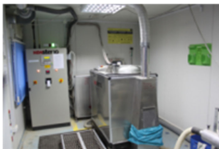
Фото 30 Установка для обезвреживания медицинских отходов – «Ньюстер 10»
