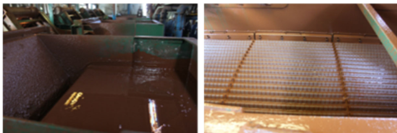
Фото 47 Установка очистки бурового раствора
