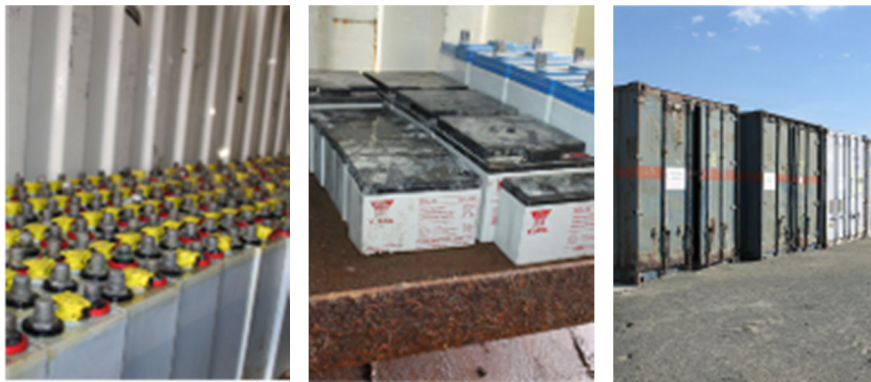
Фото 1 Площадка временного накопления для отработанных аккумуляторов на ТЭЦ
