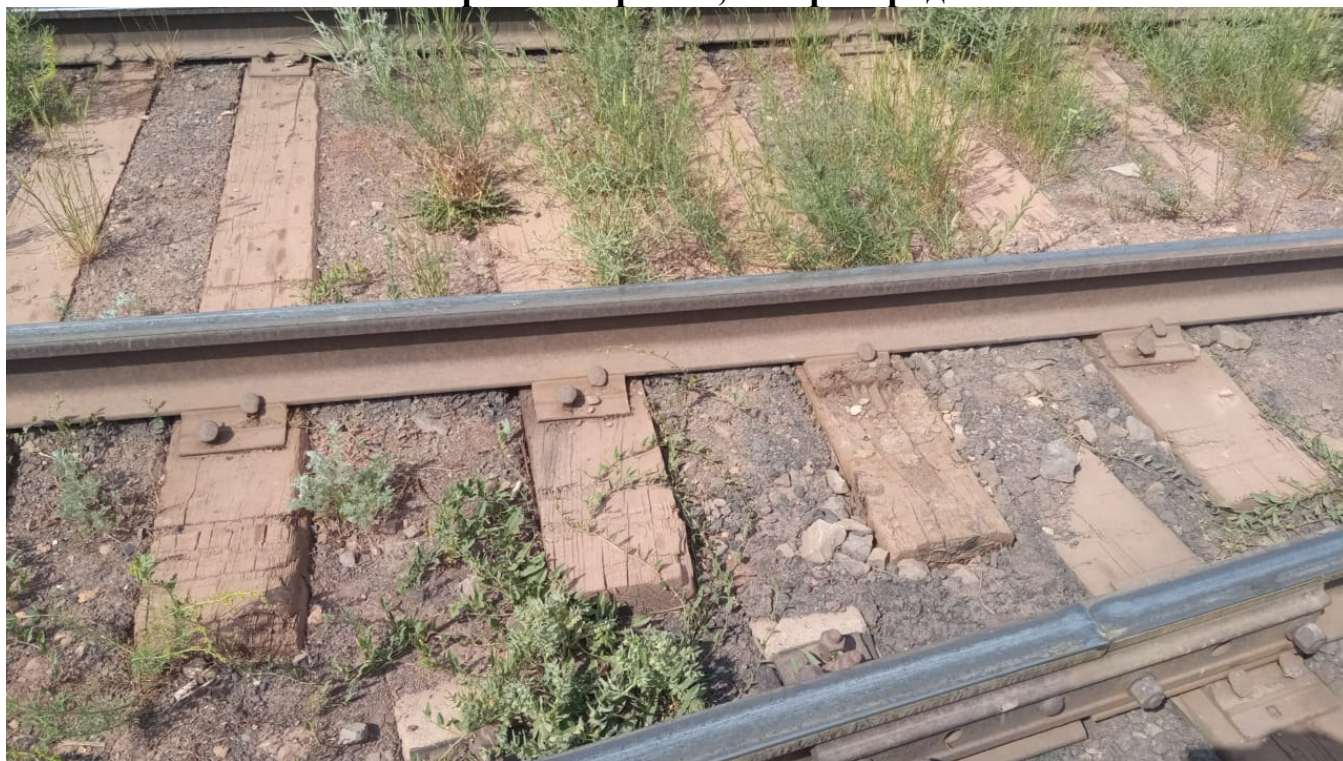
Фото №1. Состояние железнодорожного пути
