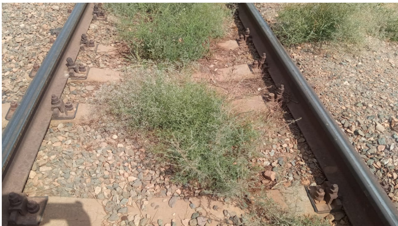
Фото №2. Состояние железнодорожного пути
