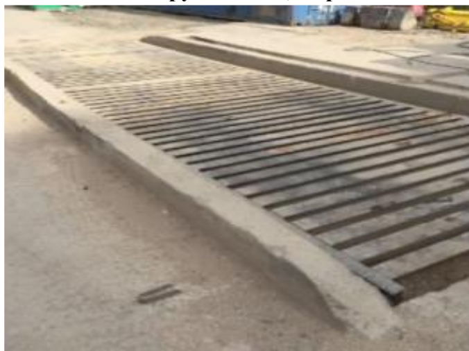
Мойка оборудованная, с приямком.
