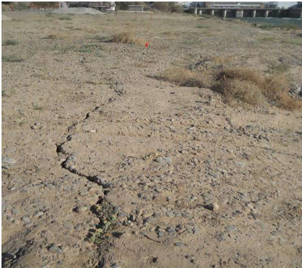
Фото 5.3 2024 год. Трещины в грунте правого берега в НБ. В настоящее время береговой склон стабилен.
