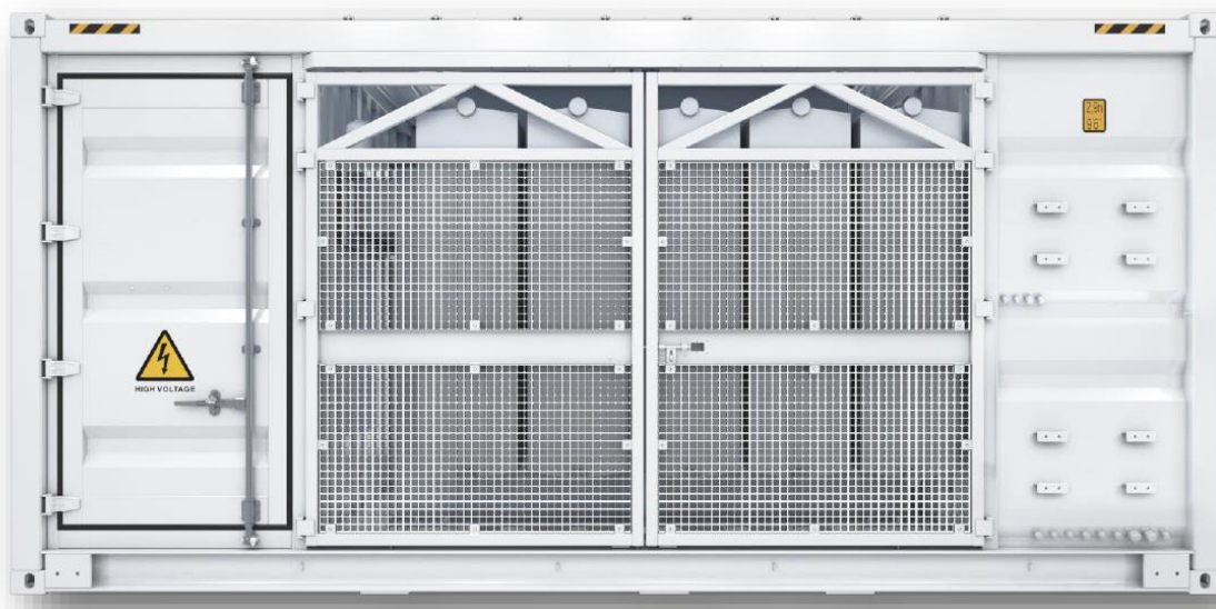
Рисунок 3-2 Общий вид трансформаторной подстанции
