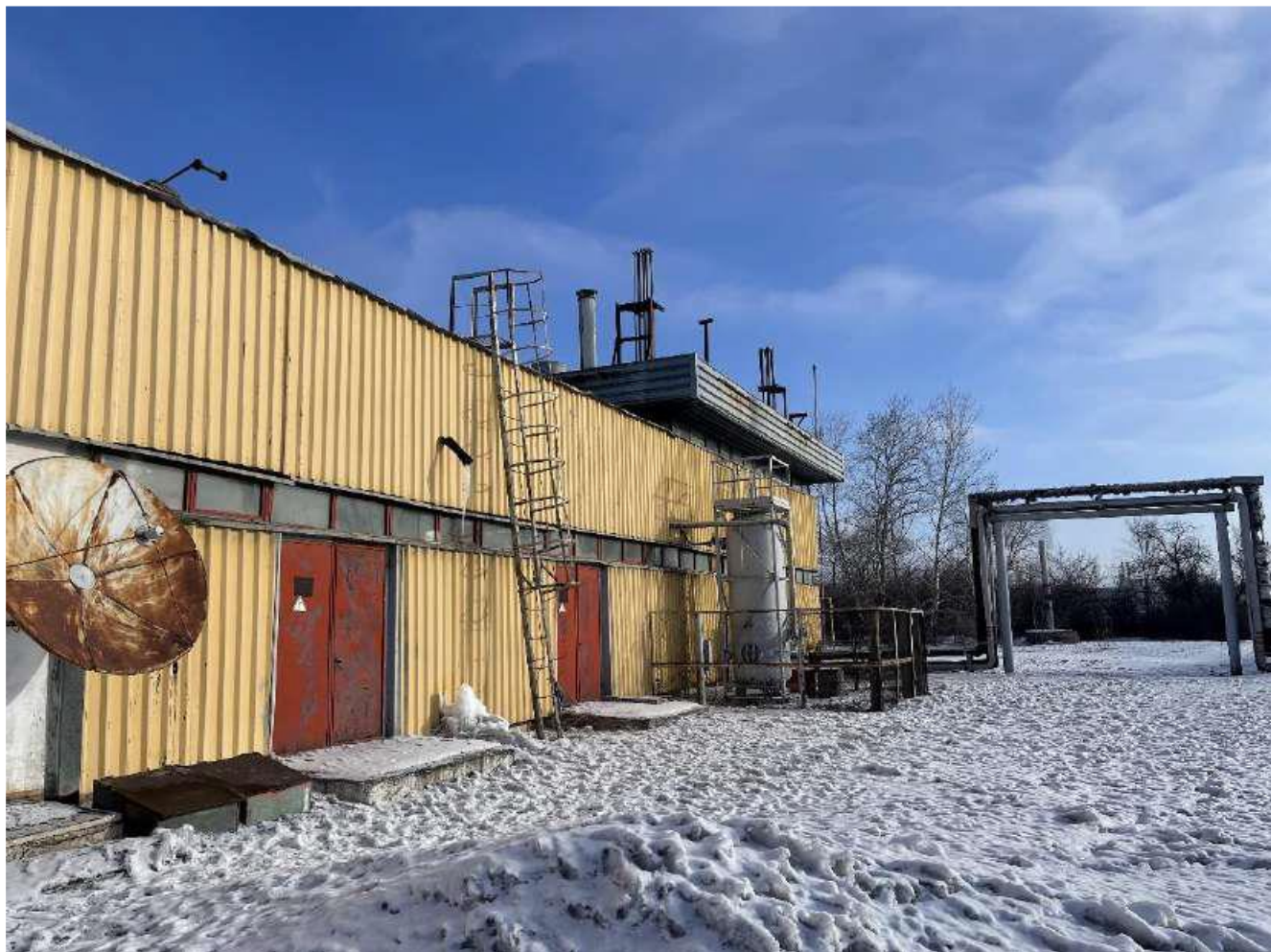
Фото 2. Здание производственно-технического корпуса состоит из 2-х примыкающих друг к другу блоков. Первый блок расположен в осях 1-5/А-Г, размерами 24,0х18,0х6,0(н)м, второй блок в осях 6-8/А-Г, размерами 12,0х18,0х4,3(н)м. Расстояние между блоками составляет 550мм. К зданию в осях 2-3/Г-Н примыкают конструкции крытой газозаправочной станции.
